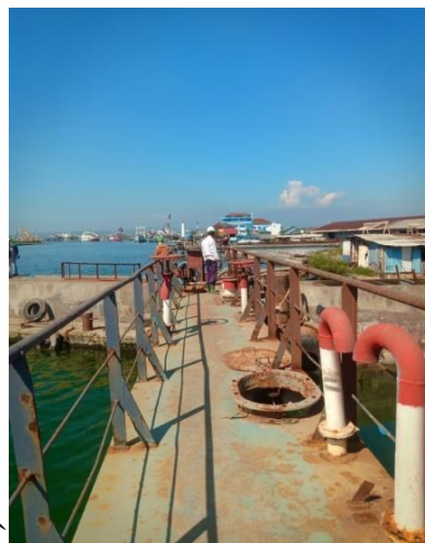
Gambar 3.9 Kran – kran pada pintu graving dock
