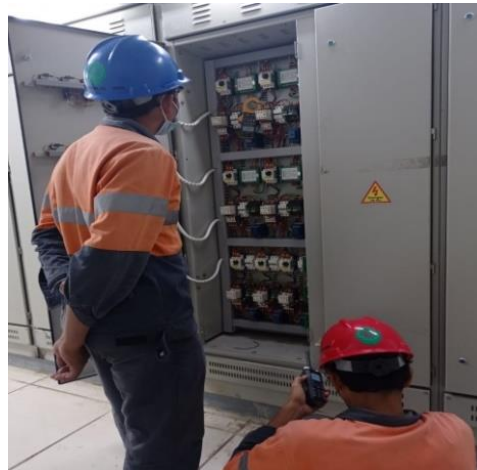
Gambar 2.21 Panel Kontrol Elektro Motor PU 10303 Sumber : PT. Wilmar Bioenergi Indonesia, (2022)
