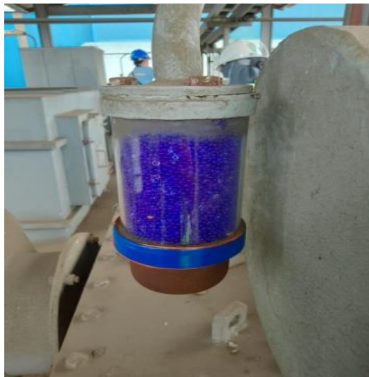
Gambar 2.35 Silica Gel Trafo ESP1 dan 2 Sumber : PT. Wilmar Bioenergi Indonesia, (2022)
