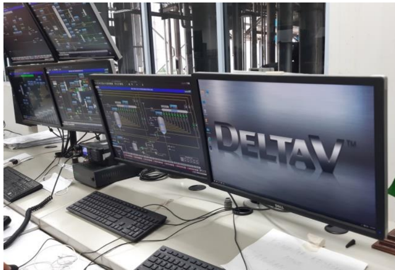
Gambar 3.10 Meja operator pada OWS Sumber : PT. Wilmar Bioenergi Indonesia, (2022)
