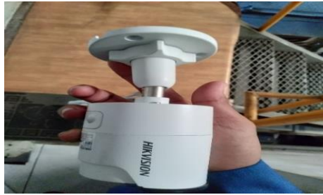
Gambar 2. 31 Pemasangan Dan Pengecekan Cctv (Sumber: PT. WINA OLEO CHEMICAL, 2022)
