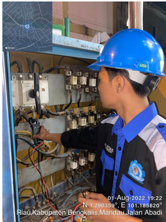
Lampiran 4. Gambar Mengukur Tegangan dan Beban Di PHB-TR.
