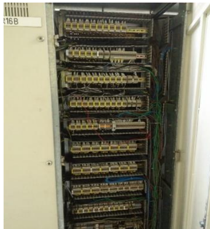
Gambar 2.4 terminal block control (Sumber: Dokumentasi PT. Indah Kiat pulp & paper Tbk Perawang, 2022)
