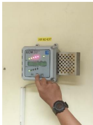
Gambar 2.11 Sensor ECM (Sumber : Dokumentasi PT. Indah Kiat pulp & paper Tbk Perawang, 2022)
