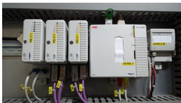
Gambar 3.7 Advand Controller 800 (Sumber : Dokumentasi PT. Indah Kiat pulp & paper Tbk Perawang, 2022)
