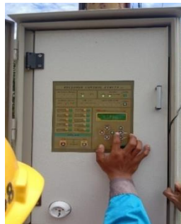
Gambar 2.28 mengecek recloser (Sumber : Dokumentasi Penulis, 2022)
