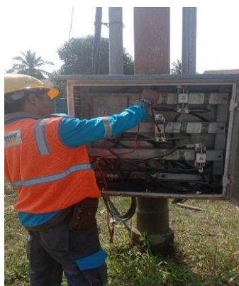
Gambar 2.21 penyeimbangan trafo (Sumber : Dokumentasi Penulis, 2022)
