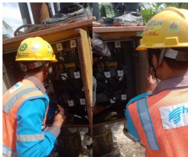
Gambar 2.39 penyeimbangan trafo (Sumber : Dokumentasi Penulis, 2022)
