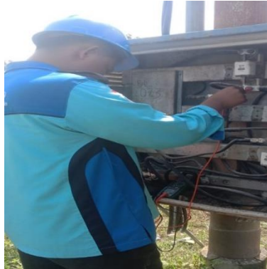
Gambar 2.4 Penyeimbangan Trafo Distribusi (Sumber : Dokumentasi Penulis, 2022)
