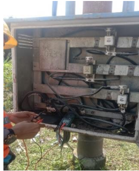
Gambar 2.27 Penyeimbangan Trafo (Sumber : Dokumentasi Penulis, 2022)
