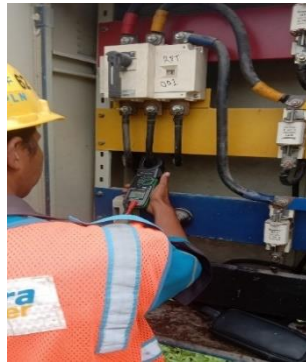
Gambar 2.41 penyeimbangan Trafo (Sumber : Dokumentasi Penulis, 2022)
