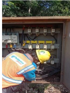
Gambar 2.29 Penyeimbangan Trafo (Sumber : Dokumentasi Penulis, 2022)
