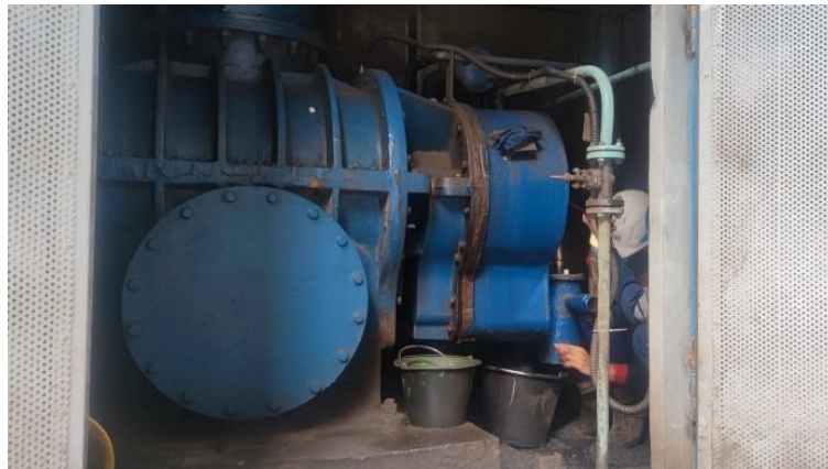
Gambar 2. 4 Monitoring Pada HPFF
