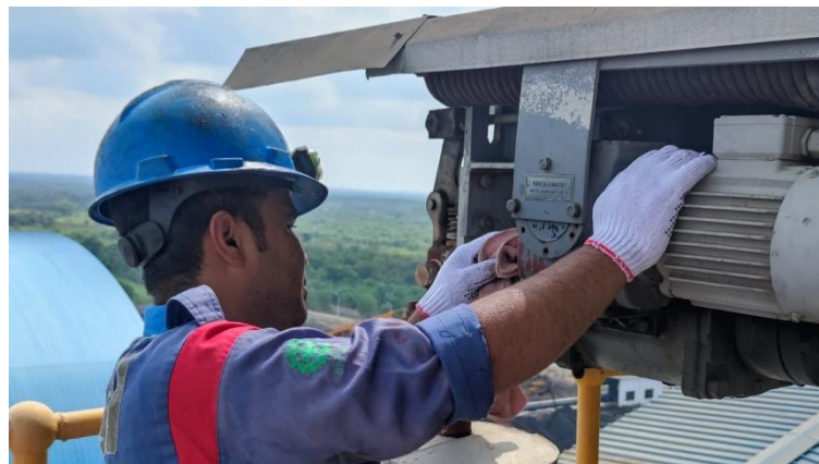
Gambar 3. 3 PM di area sub blower
