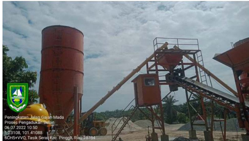
Gambar 3.11 Batching Plant Sumber : Dokumentasi lapangan, 2022
