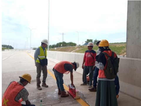
Gambar 3. 10 Retroreflektif Marka Jalan Sumber : Dokumentasi Kerja Praktek, 2022
