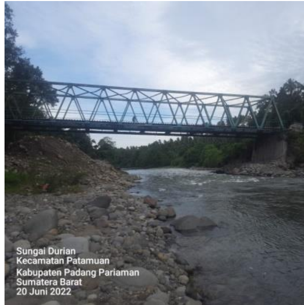
Gambar 1. 1 Jembatan sebelum dilakukan rehabilitasi
