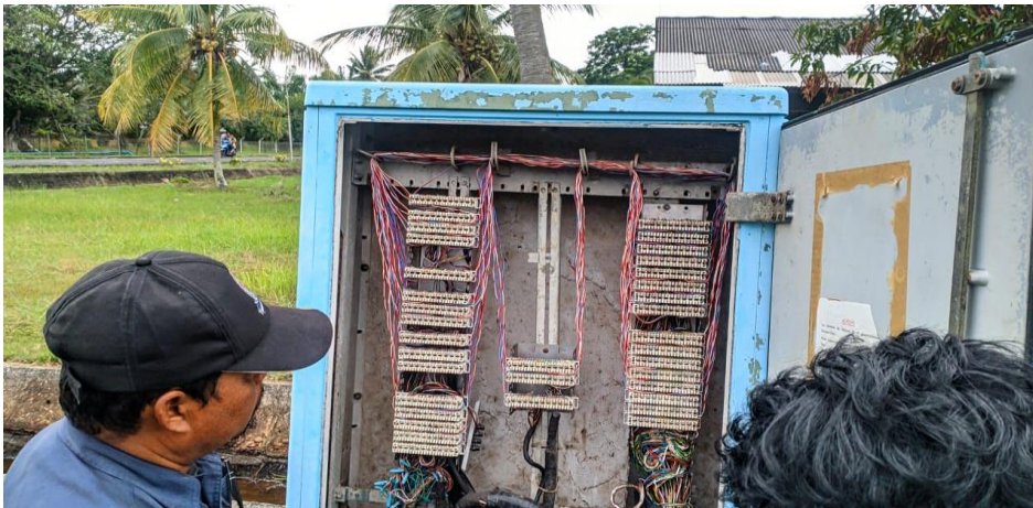
Gambar 3.2 RK(Rumah Kabel) tempat penyambungan kabel telephone
