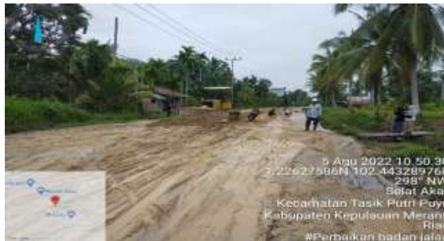
Gambar 3. 22 kondisi jalan rusak Sumber: (Dokumentasi, 2022)
