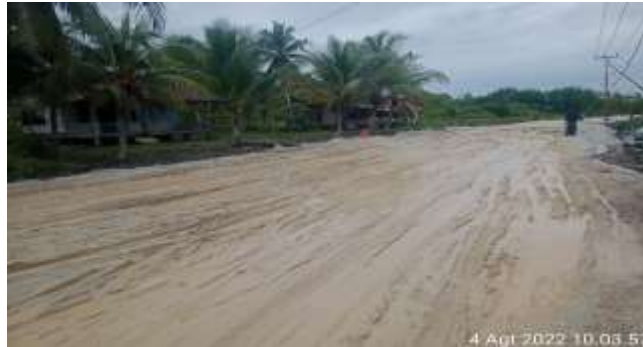
Gambar 3. 21 jalan rusak akibat hujan Sumber: (Dokumentasi, 2022)
