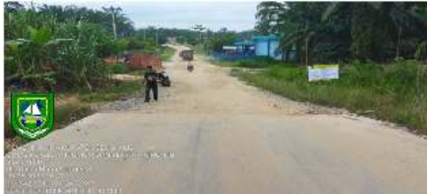
Gambar 1.1 Gambar Jalan Tasik Serai Sebelum Peningkatan (Sumber : Dokumentasi Lapangan 2022)
