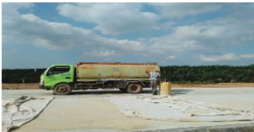
Gambar 3.8 Alat water tank (sumber :dokumentasi lapangan ,2022)
