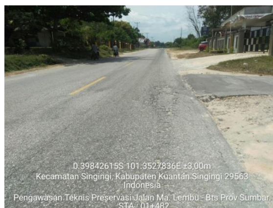
Gambar 1.1 : Kondisi Jalan Sebelum Diperbaiki
