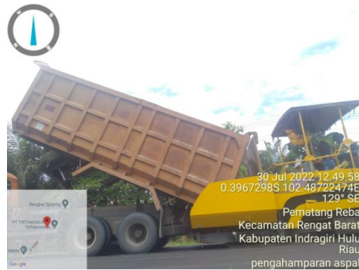
Gambar 4.17 Proses Masuk Laston Lapis Aus (AC-WC) ke dalam Asphalt Finisher (Sumber: Dokumentasi Lapangan Kerja Praktek 2022)
