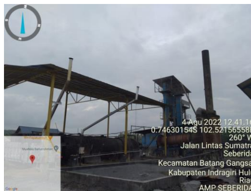
Gambar 4.2 AMP Tipe Batch Plant (Sumber: Dokumentasi Lapangan Kerja Praktek 2022)
