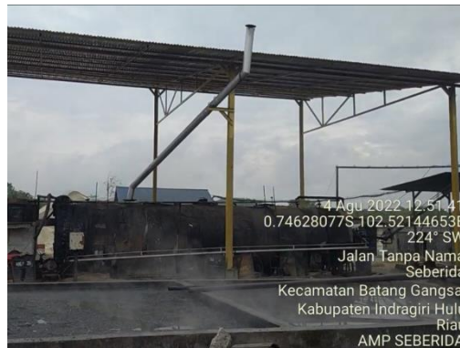
Gambar 4.12 Pemanasan Aspal pada boiler fire tube (Sumber: Dokumentasi Lapangan Kerja Praktek 2022)
