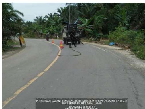
Gambar 4.14 Pekerjaan Air Compressor
