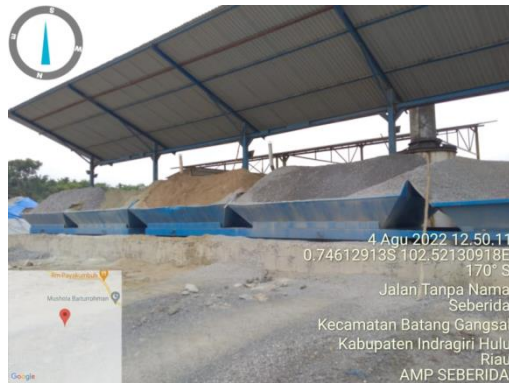
Gambar 4.10 Pemisahan Agregat di Colt Bin (Sumber: Dokumentasi Lapangan Kerja Praktek 2022)
