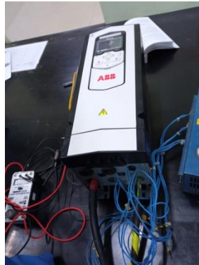
Gambar 2. 9 pengoperasian Variable Speed Drive ACS-880 dikontrol dengan modul remote
