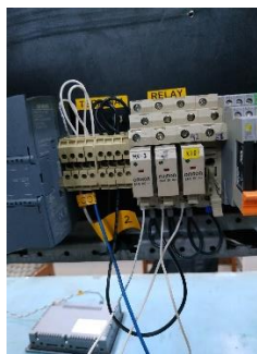
Gambar 2.12 Menghubungkan switch ke CPU dengan Output Relay
