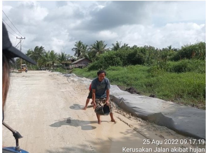
Gambar 3.14 pembuangan air yang mengenang Sumber : (Dokumentasi Lapangan, 2022)
