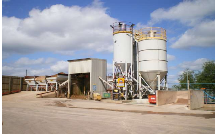
Gambar 3. 23 Batching Plant Sumber: Dokumentasi internet, tahun 2022
