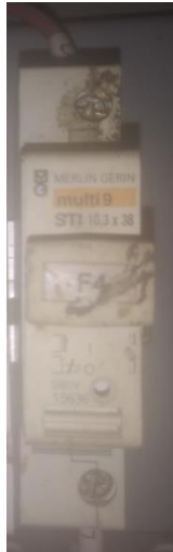
Gambar 1.8 Fuse Dan Fuse Holder (Sumber: Dokumentasi PT. Bukaka Teknik Utama Duri, 2022)
