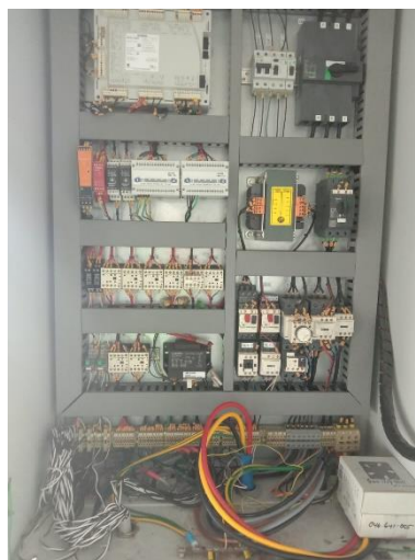
Gambar 2.1 Panel boiler (sumber: dokumentasi penulis. 2022)
