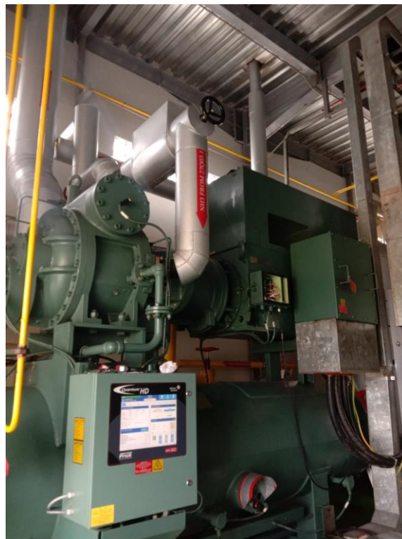
Gambar 2.4 Kompresor ammonia (sumber: dokumentasi penulis 2022)
