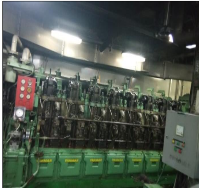
Gambar 2.21 Kondisi Engine Room Kapal Sumber : Dokumentasi penulis
