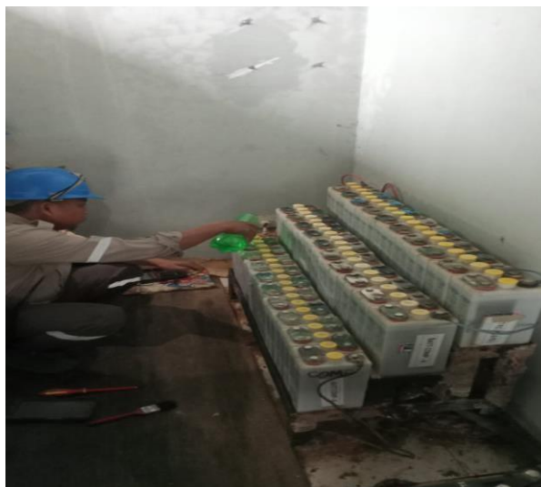
Gambar 2. 2 Monitoring kondisi baterai (Sumber : Dokumentasi 2022)
