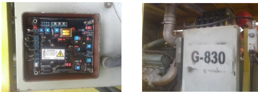
Gambar 2. 3 Pemeliharaan emergency genset (Sumber : Dokumentasi 2022)
