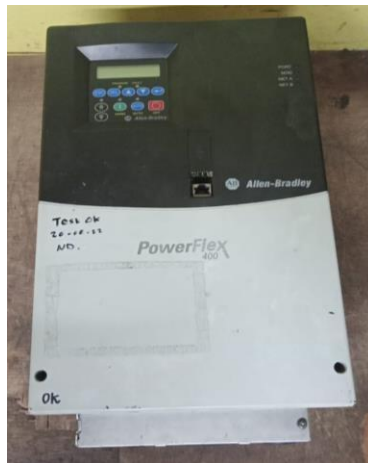
Gambar 3. 1 Panel Variable Speed Drive (VSD) (Sumber: Dokumentasi 2022)
