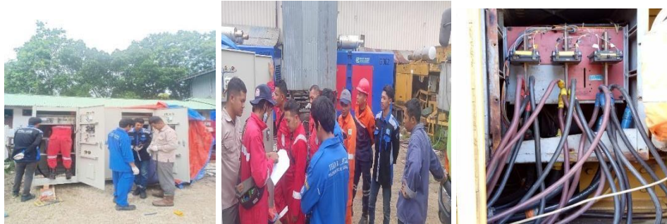
Gambar 2. 4 Tes kemampuan genset menggunakan load bank (Sumber : Dokumentasi 2022)
