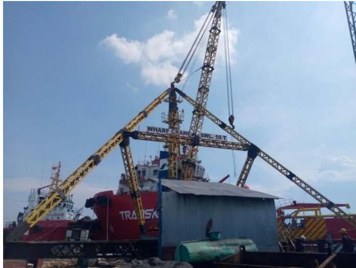
Gambar 1.17 Crane di PT. Yasa Wahana Tirta Samudera. Sumber : Dokumentasi penulis
