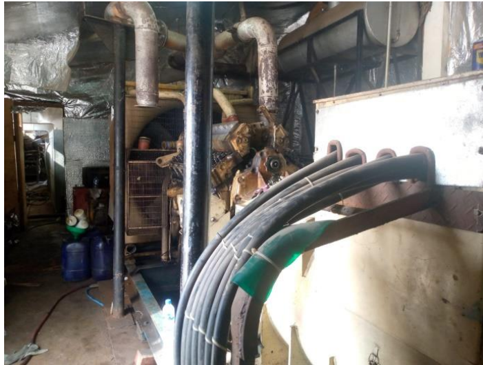
Gambar 1.10 Kelistrikan PT. Yasa Wahana Tirta Samudera. Sumber : Dokumentasi penulis
