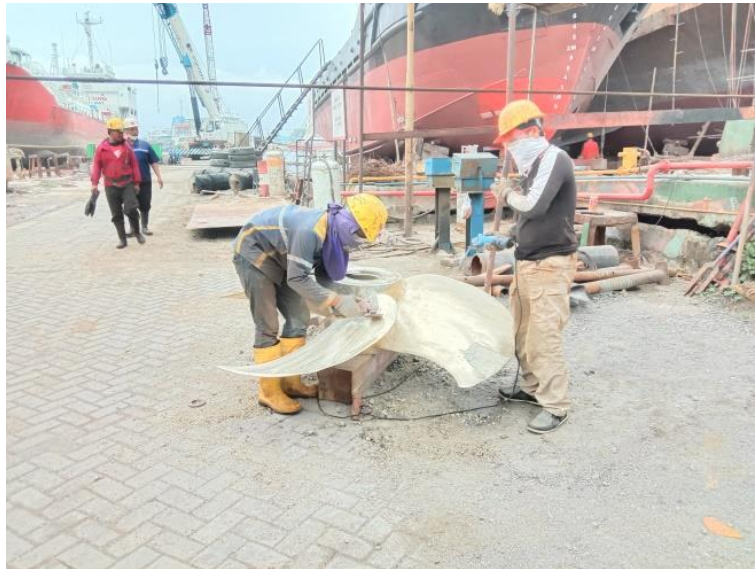
Gambar 2.26 Proses repair propeller kapal Mandiri 5 dan kapal TB. Patra Tunda 4201. Sumber : Dokumentasi penulis
