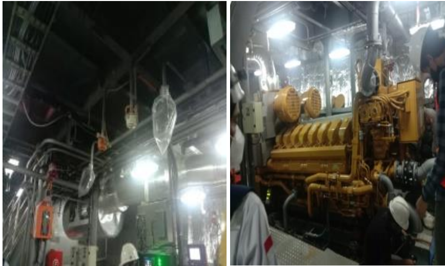
Gambar 2.32 Pemeriksaan Fire Pump Emergency pada Engine Room dan Engine Safety Device Tests Report 4. Hari Kamis (Tanggal 10 November 2022)
