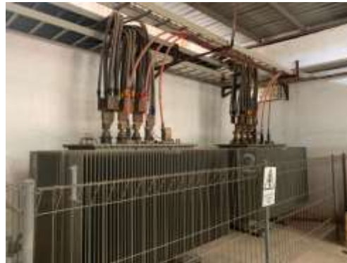
Gambar 2.15 Trafo Jenis Step Up
