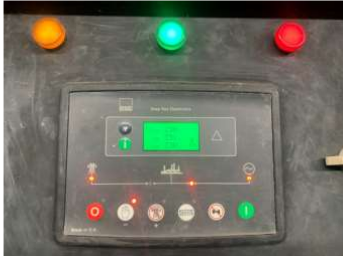
Gambar 3.12 Mesin Generator Sudah Siap Untuk Sinkronisasi
