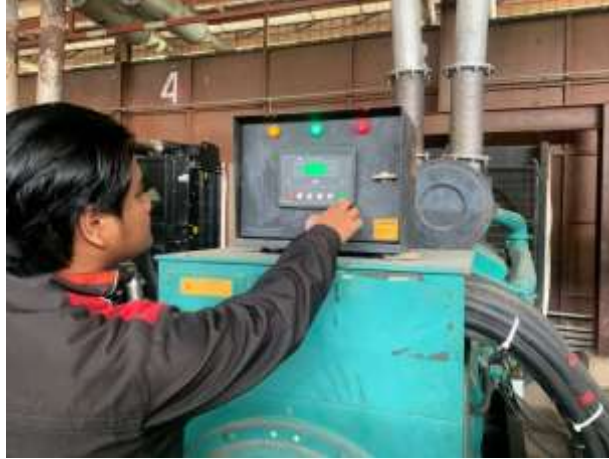
Gambar 3.11 Proses Menghidupkan Mesin Generator Menggunakan Modul DEEP SEA ELECTRONICS MKII
