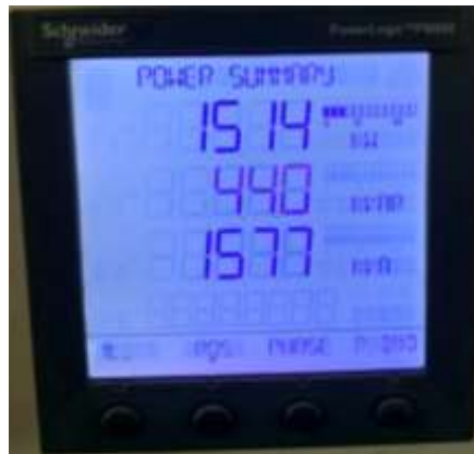
Gambar 2.12 Pembacaan Beban Total Kawasan di Power Meter
