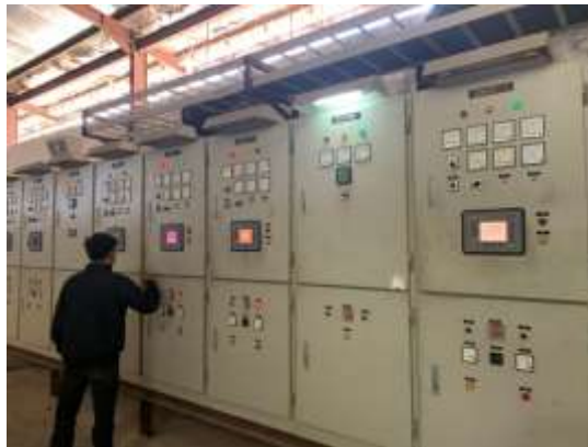
Gambar 2.10 Proses Mematikan Mesin Generator Melalui Panel Sinkron
