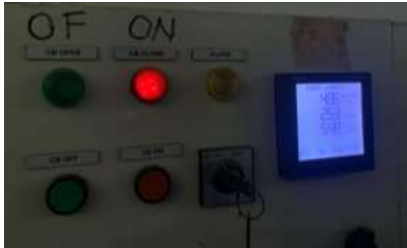
Gambar 2.7 PGC Generator Kondisi CB Close
