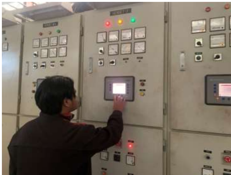
Gambar 3.14 Proses Pengoperasian Mesin Generator Menggunakan Modul WOODWARD EASYGEN 3000
