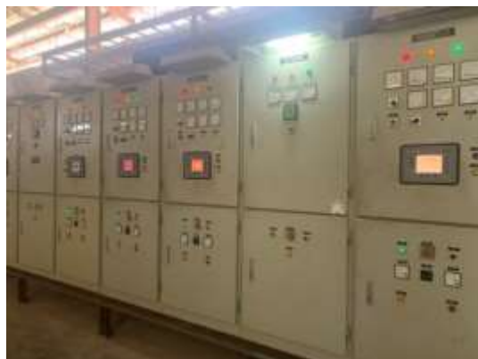
Gambar 2.4 Panel Sinkron Setelah Dilakukan Sinkronisasi
