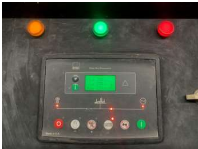
Gambar 3.16 Tampilan Layar Modul DEEP SEA ELECTRONICS MKII Setelah Mesin Generator Menyala
