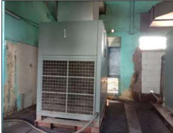
Gambar 1.6 Kompresor PT. Yasa Wahana Tirta Samudera Sumber : Dokumentasi penulis
