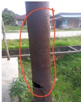
Gambar 2.21. Melihat Tiang Keropos (Sumber: PT. Haleyora Power, 2022)
