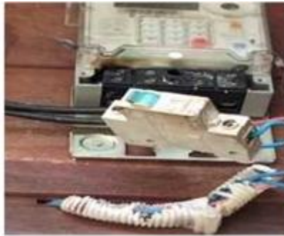
Gambar 2.34. Gangguan Pada kWh (Sumber: PT. Haleyora Power, 2022)
