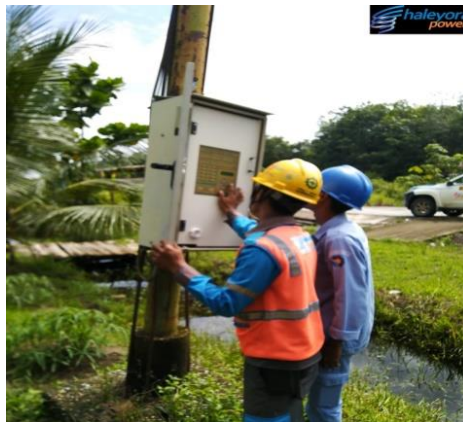
Gambar 2.2. Siaga Pada Reclser trip (Sumber: PT. Haleyora Power, 2022)
