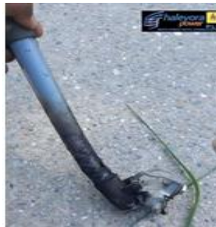
Gambar 2.37. Melepaskan FCO Karena Sudah Terbakar (Sumber: PT. Haleyora Power, 2022)
