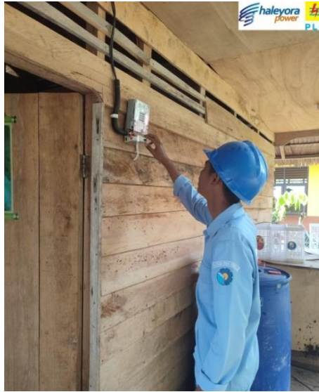
Gambar 2.8. Memasukan Kode Clear Tamper (CT) (Sumber: PT. Haleyora Power, 2022)
