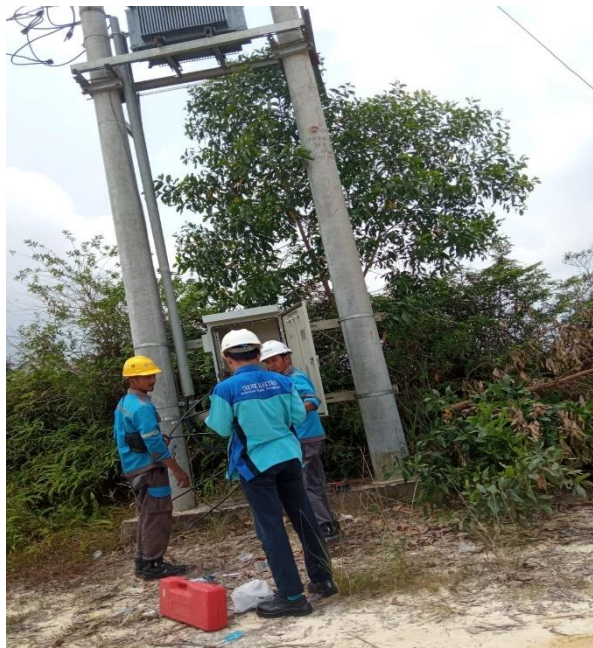
Lampiran 2. Mengaktifkan trafo
