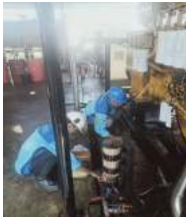
Gambar 2.7 Membersihkan oli (Sumber: PT. Megapower Makmur Tbk. 2022)
