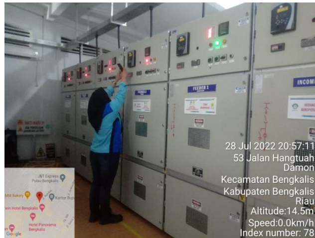
Gambar 2.14 Evident Beban Feeder (Sumber: Dokumentasi,2022)
