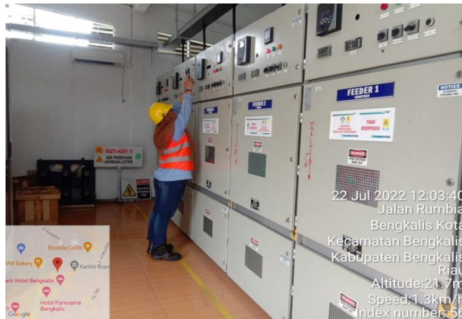
Gambar 2.10 Evident Beban Feeder (Sumber: Dokumentasi,2022)
