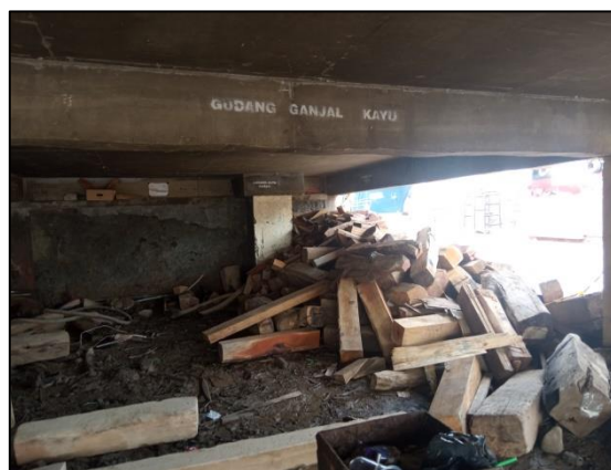
Gambar 1.18 Stop Block Sumber : Dokumentasi penulis
