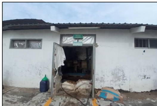
Gambar 1.10 Kelistrikan PT. Yasa Wahana Tirta Samudera. Sumber : Dokumentasi penulis.
