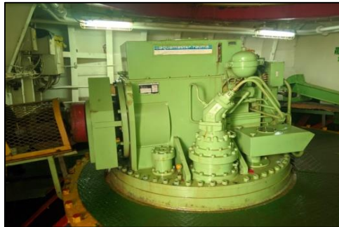
Gambar.2.30 Aquamaster rauma bagian starboard Sumber : Dokumentasi penulis.
