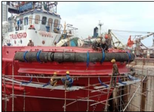
Gambar.2.51 Pemasangan rantai untuk Rubber Fender pada kapal TB. Patra Tunda 4201. Sumber : Dokumentasi penulis.
