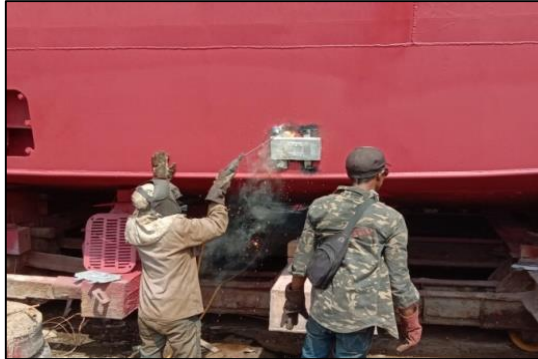
Gambar.2.61 Proses pemasangan Zinc Anode pada kapal tug boat Sumber Marine 2. Sumber : Dokumentasi penulis.
