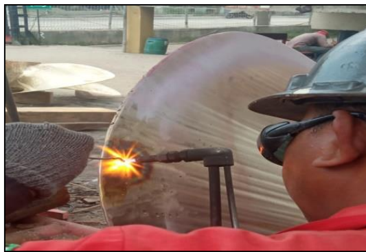
Gambar 2.92 Proses penambahan daging untuk propeller kapal TB Transko Murai Sumber : Dokumentasi penulis.
