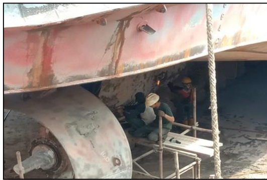
Gambar 2.89 Proses penurunan propeller kapal TB. Transko Murai dan Wallet. Sumber : Dokumentasi penulis.
