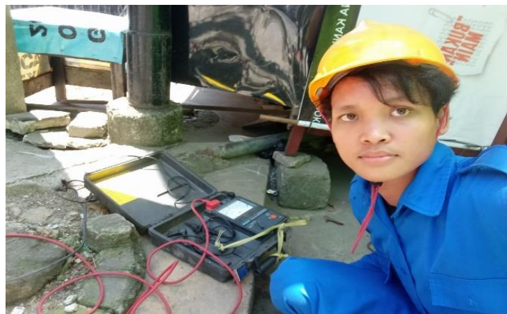
Gambar 2.43. Mengukur Tahanan Trafo Sumber : PT PLN PERSERO ULP Medan Kota”
