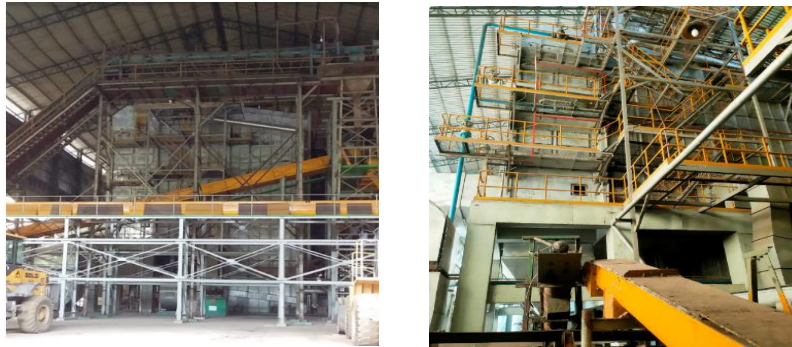
Gambar 2. 1 Photo Stasiun Engine Room (Sumber: Dokumentasi , 2022)
