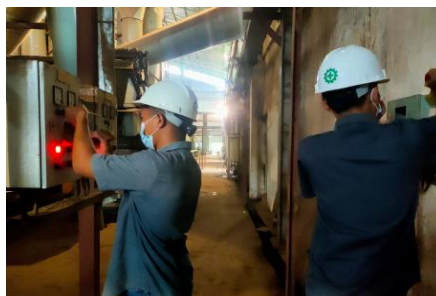
Gambar 2. 6 Maintenance panel ( sumber: Dokumenasi, 2022 )
