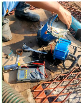
Gambar 2. 3 Maintenance Pompa Air Celup (Sumber: Dokumentasi, 2022)
