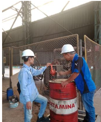
Gambar 2. 21 Pengecekan Genset (Sumber: Dokumentasi, 2022)
