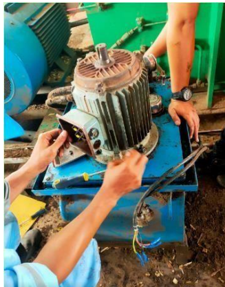
Gambar 2.7 Open install motor 3 phasa (Sumber: dokumentasi 2022)
