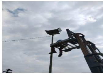
Gambar 2.10 lampu sorot (Sumber: dokumentasi, 2022)
