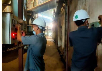
Gambar 2.6 Maintenance panel (Sumber: dokumentasi, 2022)
