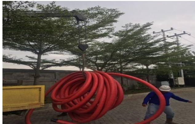
Gambar 2. 5 kabel tanah (Sumber: Dokumentasi 2022)
