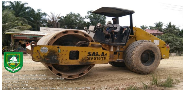
Gambar 3. 38 Penyiapan badan jalan, pengukuran kedalaman base, dan pepadatan base B Sumber : Dokumentasi Lapangan, 2022
