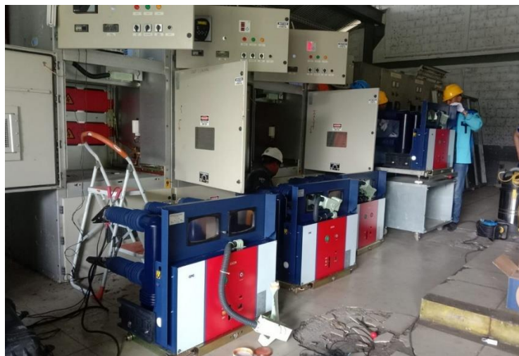
Gambar 2. 8 Pemeliharaan GH (Gardu Hubung) (Sumber : Dokumentasi, 2022)
