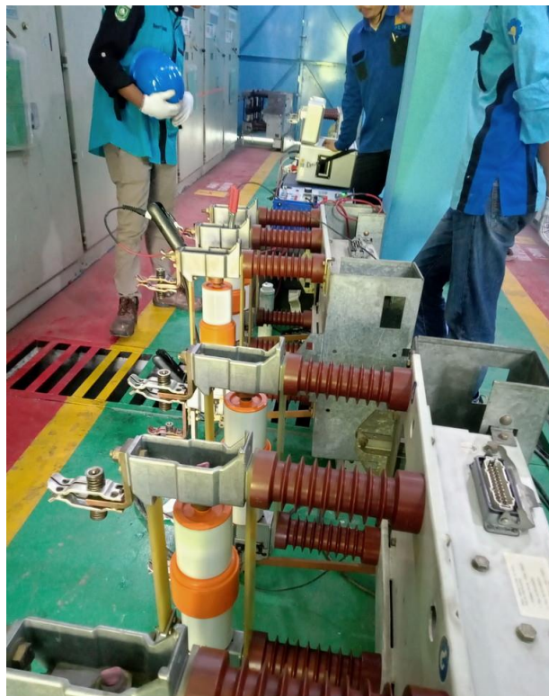
Gambar 2. 20 Pemeliharaan GH (Gardu Hubung) (Sumber : Dokumentasi, 2022)
