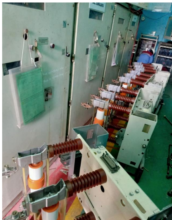
Gambar 2. 14 Pemeliharaan GH (Gardu Hubung) (Sumber : Dokumentasi, 2022)
