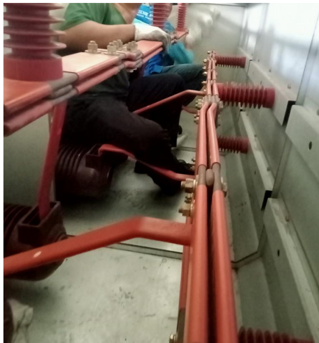
Gambar 2. 11 Pemeliharaan GH (Gardu Hubung) (Sumber : Dokumentasi, 2022)
