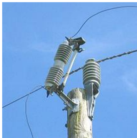
Gambar 3. 5 Fuse Cut Out (FCO) (Sumber : Dokumentasi, 2022)
