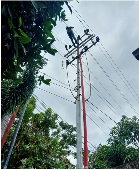
Gambar 2. 22 Pemasangan Arrester (Sumber : Dokumentasi, 2022)
