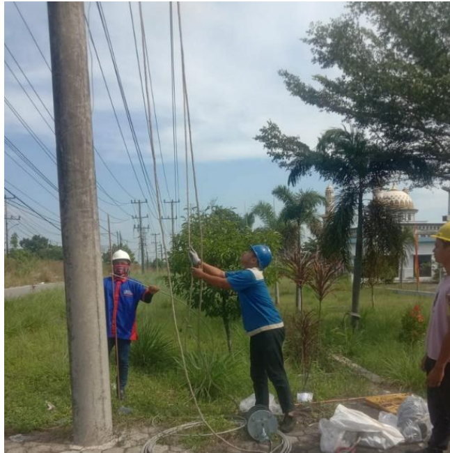
Gambar 2. 18 Pemasangan LBS ( Load Break Switch ) (Sumber : Dokumentasi, 2022)
