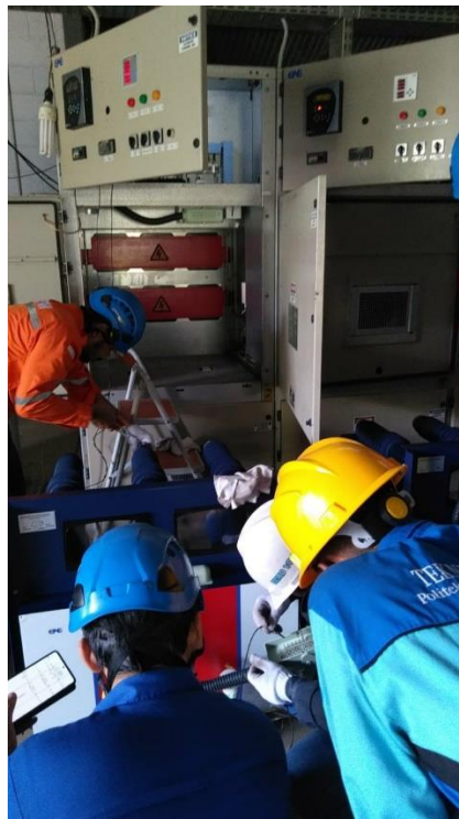
Gambar 2. 17 Pemeliharaan GH (Gardu Hubung) (Sumber : Dokumentasi, 2022)
