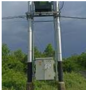
Gambar 3. 1 Gardu Distribusi PHB-TR (Sumber: Dokumentasi, 2022)
