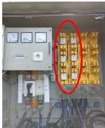
Gambar 3. 5 NH Fuse atau Sekring (Sumber: Dokumentasi, 2022)
