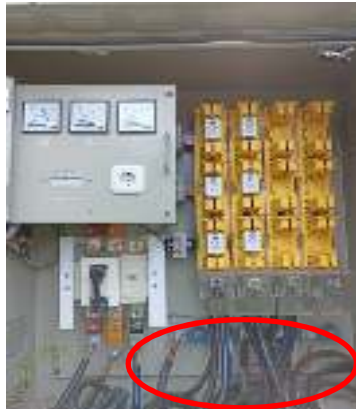
Gambar 3. 6 Kabel Opstyg (Sumber: Dokumentasi, 2022)
