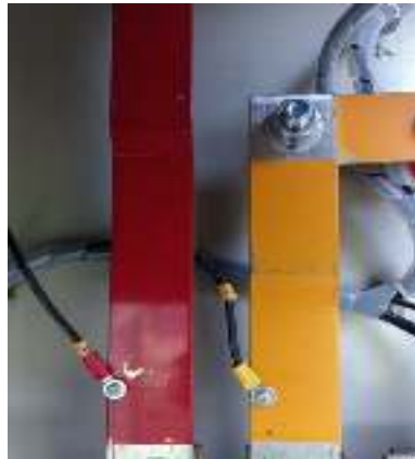
Gambar 3. 3 Busbar atau Saluran Pembagian (Sumber: Dokumentasi, 2022)
