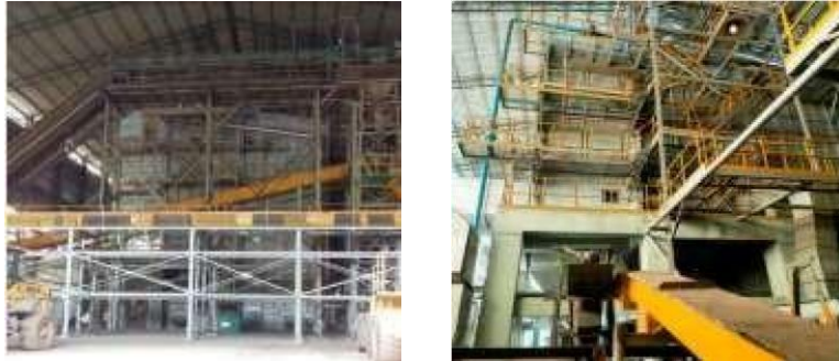
Gambar 2.1 Photo stasiun engine room (Sumber:Dokumentasi , 2022)
