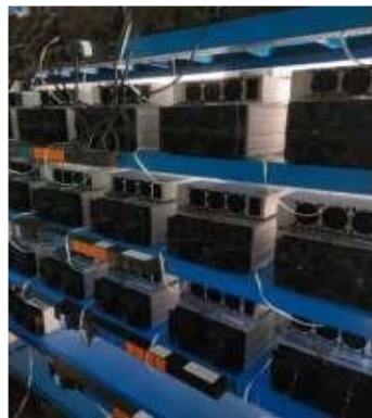
Gambar 2.19 Photo install data center (Sumber: dokumentasi, 2022)
