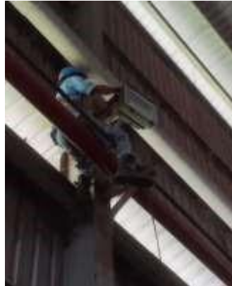
Gambar 2.9 Photo installation lampu sorot (Sumber:dokumentasi, 2022)
