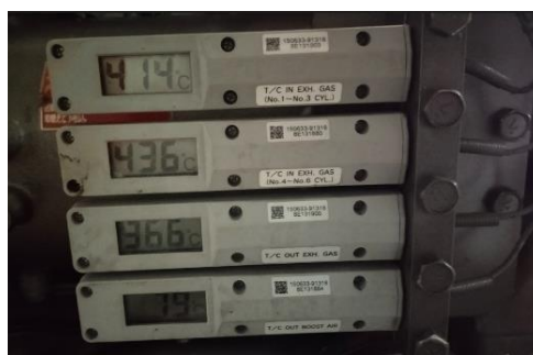
Gambar 3.1 Pencatatan Suhu Gas Buang pada Cylinder No. 1-6 , Suhu Gas Buang yang Dikeluarkan, dan Suhu Udara Tambahan.
