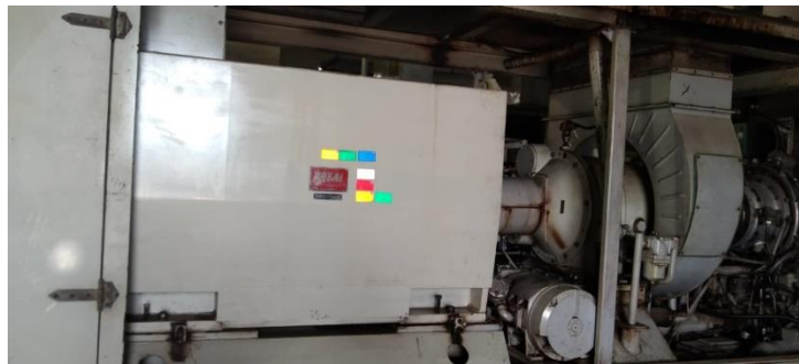
Gambar 3.1. Generator PT.Pertamina RU II Sungai Pakning
