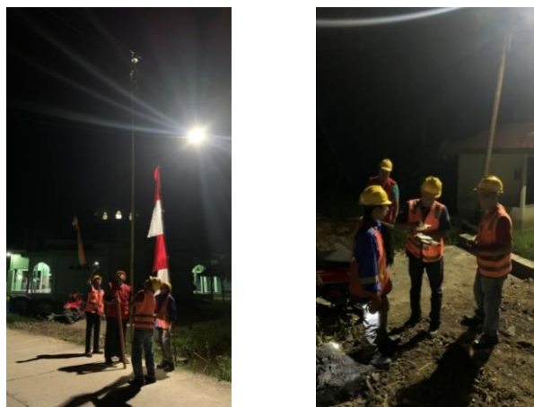
Gambar 2.21 Pengukuran JTM (Sumber: PLN. Rayon bengkalis PT. Adra gemilang. 2022)
