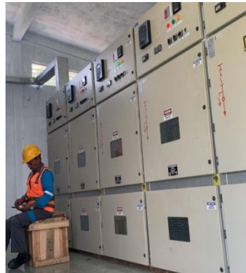
Gambar 2.8 Pengecekan data beban feeder di GH Selat Baru (Sumber: PLN. Rayon bengkalis PT. Adra gemilang. 2022)
