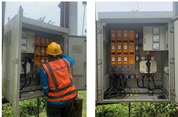
Gambar 2.12 Trafo bagian dalam (Sumber: PLN. Rayon bengkalis PT. Adra gemilang. 2022)
