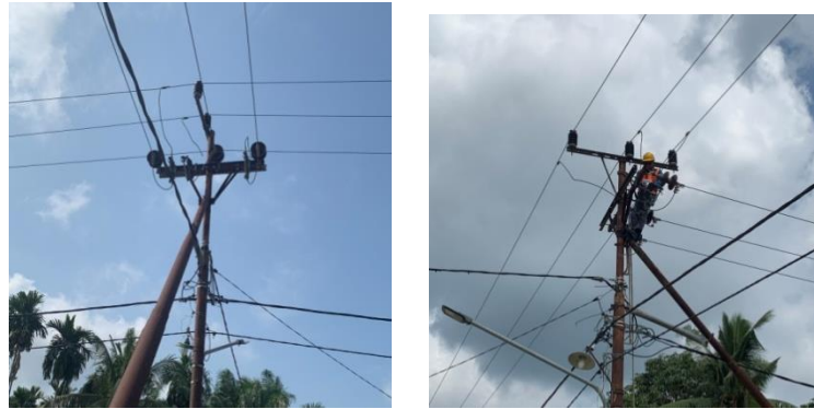
Gambar 2.20 Perbaikan kabel TM putus (Sumber: PLN. Rayon bengkalis PT. Adra gemilang. 2022)
