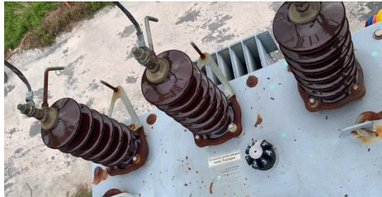
Gambar 3.3 Bushing trafo (Sumber : PLN. Rayon Bengkalis PT. Adra gemilang. 2022)
