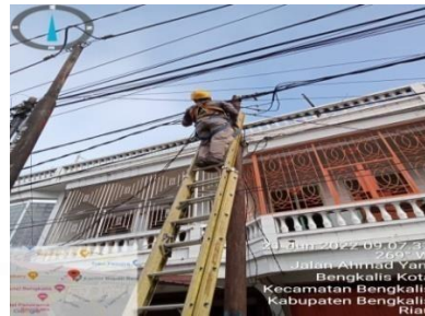
Gambar 2.14 Pemindahan phasa pelanggan yang besar ke kecil Sumber: PLN. Rayon Bengkalis PT. Adra Gemilang 2022
