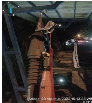
Gambar 2.56 Pengukuran tegangan kabel JTM ( Jaringan tegangan menengah ) Sumber: PLN. Rayon Bengkulu PT. Adra Gemilang 2022
