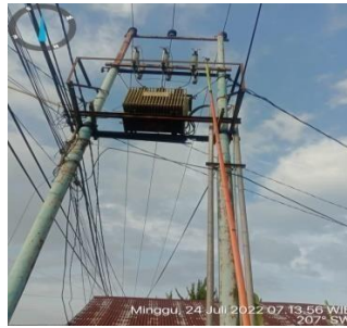
Gambar 2.36 Mengganti fuse link Fco ( fuse cut out ) yang terputus Sumber: PLN. Rayon Bengkalis PT. Adra Gemilang 2022
