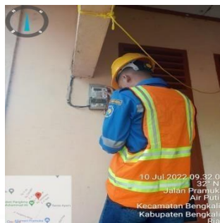
Gambar 2.26 Memasukkan kode Kct di meter pelanggan Sumber: PLN. Rayon Bengkalis PT. Adra Gemilang 2022
