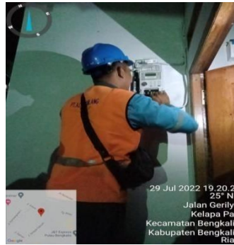
Gambar 2.39 Mengganti MCB( miniature circuit breaker ) yang lose Sumber: PLN. Rayon Bengkalis PT. Adra Gemilang 2022
