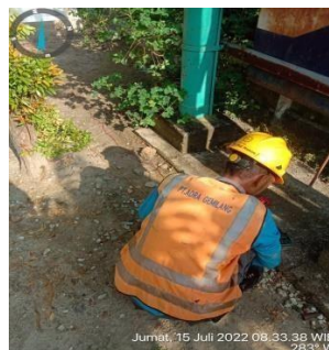
Gambar 2.29 Pentanahan yang dilakukan pada trafo
