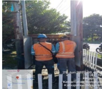
Gambar 2.19 Pengukuran beban trafo
