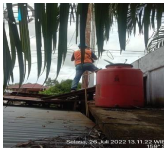
Gambar 2.38 Mengatasi gangguan lost contact nol / netral Sumber: PLN. Rayon Bengkalis PT. Adra Gemilang 2022
