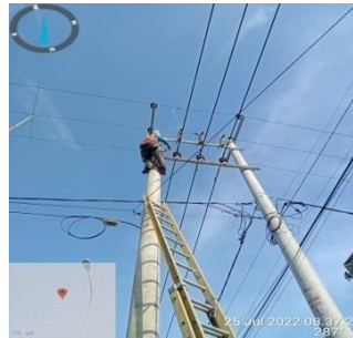
Gambar 2.37 Mengatasi jumperan Fco ( fuse cut out ) yang terputus Sumber: PLN. Rayon Bengkalis PT. Adra Gemilang 2022
