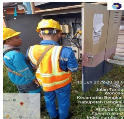
Gambar 2.9 Pengukuran beban trafo
