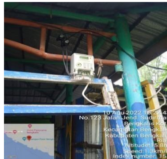
Gambar 2.47 Penggantian MCB ( miniature circuit breaker ) rusak Sumber: PLN. Rayon Bengkalis PT. Adra Gemilang 2022
