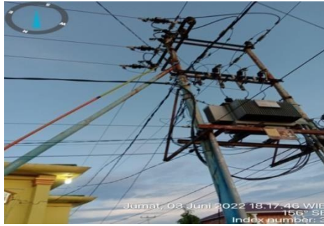
Gambar 2.2 pemutusan dan penghidupan FCO (fuse cut out) trafo Sumber: PLN. Rayon Bengkalis PT. Adra Gemilang 2022
