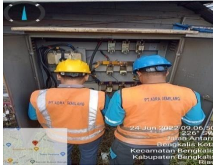
Gambar 2.16 Pengukuran beban trafo
