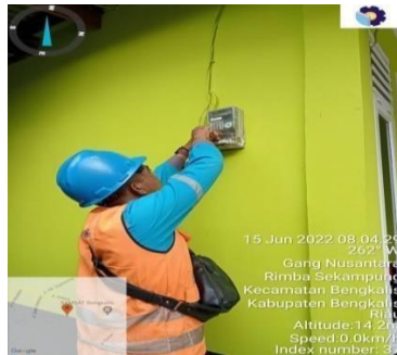
Gambar 2.11 Memasukkan kode KCT di KWh meter Sumber: PLN. Rayon Bengkalis PT. Adra Gemilang 2022
