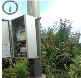
Gambar 2.5 Mengatasi RC ( recloser )
