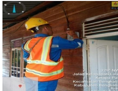
Gambar 2.13 Memasukkan kode CT ( clear tamper ) Sumber: PLN. Rayon Bengkalis PT. Adra Gemilang 2022
