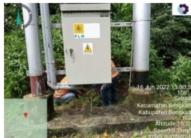
Gambar 2.12 Pembersihan trafo di desa senderak Sumber: PLN. Rayon Bengkalis PT. Adra Gemilang 2022
