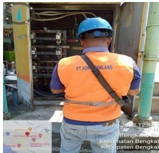
Gambar 2.23 Pengukuran beban trafo
