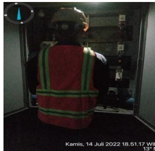
Gambar 2.28 Pengukuran beban trafo
