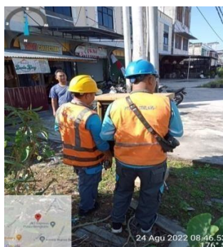
Gambar 2.57 Pengukuran beban trafo Sumber :PLN. Rayon Bengkulu PT. Adra Gemilang 2022
