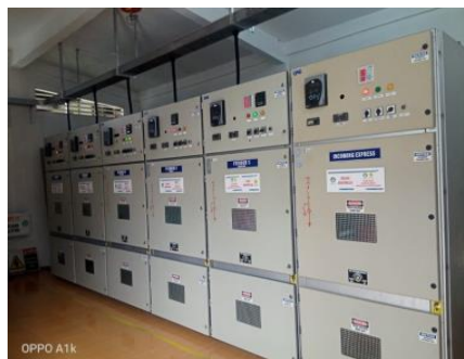
Gambar 2.32 Evident Beban Feeder (Sumber: Dokumentasi, 2022)
