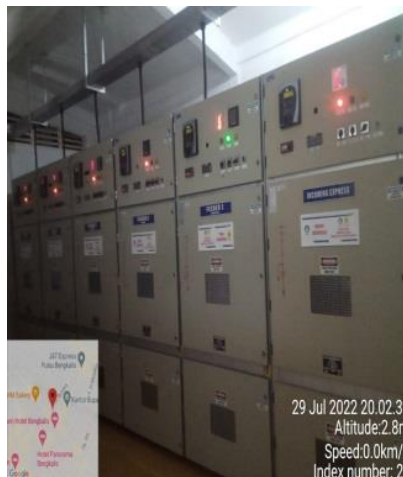
Gambar 2.17 Evident Beban Feeder (Sumber: Dokumentasi, 2022)
