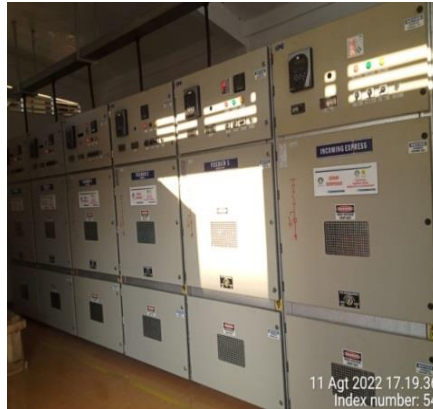
Gambar 2.26 Monitoring Beban Feeder (Sumber: Dokumentasi, 2022)
