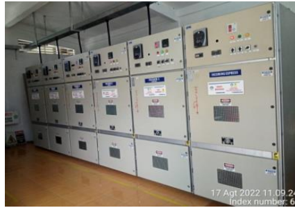
Gambar 2.30 Evident Beban Feeder (Sumber: Dokumentasi, 2022)
