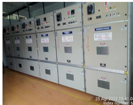
Gambar 2.36 Monitoring Beban Feeder (Sumber: Dokumentasi, 2022)
