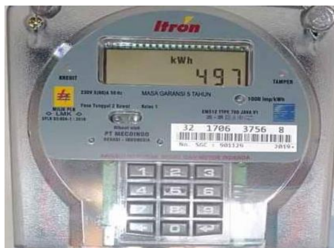
Gambar 3.4 kwh Meter gagal token (Sumber: Dokumentasi, 2022)
