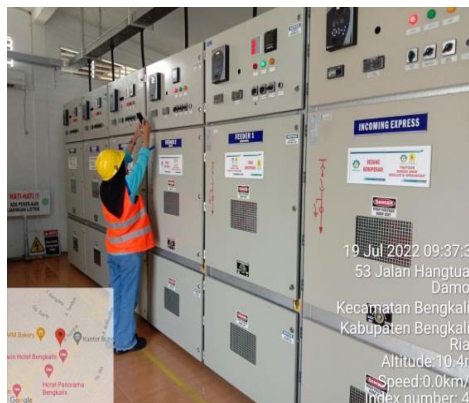
Gambar 2.9 Evident Beban Feeder (Sumber: Dokumentasi,2022)
