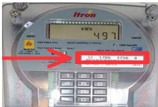
Gambar 3.8 Nomor Kwh Meter (Sumber: Dokumentasi, 2022)
