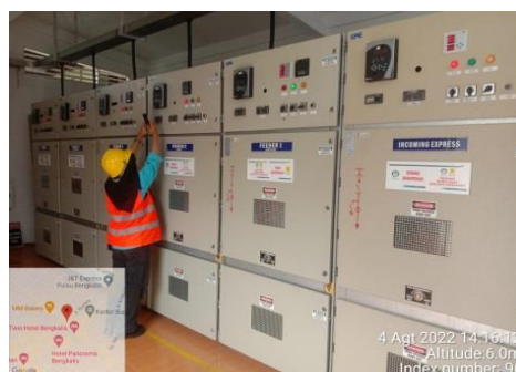
Gambar 2.21 Evident Beban Feeder (Sumber: Dokumentasi, 2022)
