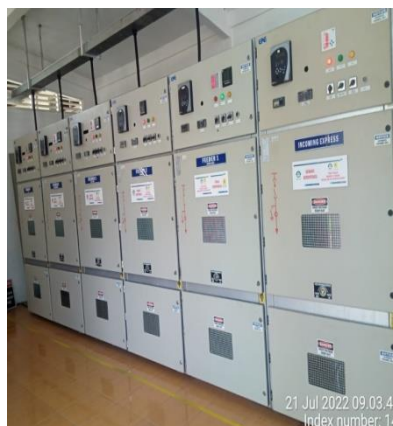
Gambar 2.11 Evident Beban Feeder (Sumber: Dokumentasi, 2022)
