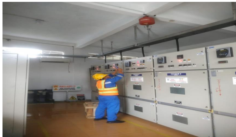
Gambar 2. 6 Evident beban feeder yang dilakukan setiap 1 jam sekali ( Sumber :okumentasi, 2022)
