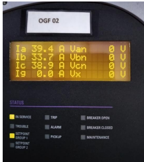
Gambar 2. 43 Evident beban feeder ( Sumber :PLN. Rayon bengkalis PT. Adra gemilang.2022)
