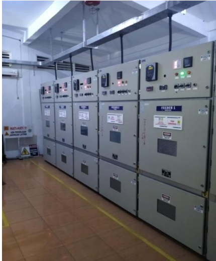
Gambar 2. 38 Evident beban feeder ( Sumber :PLN. Rayon bengkalis PT. Adra gemilang.2022)
