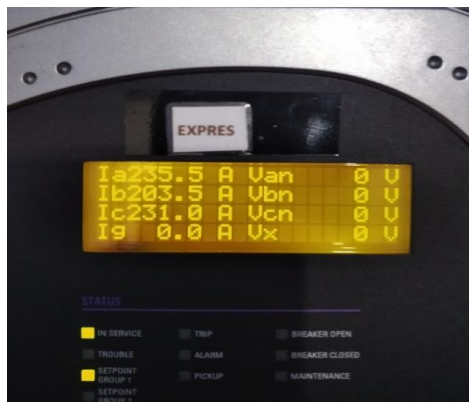
Gambar 2. 70 Memfoto feeder ( Sumber :PLN. Rayon bengkalis PT. Adra gemilang.2022)
