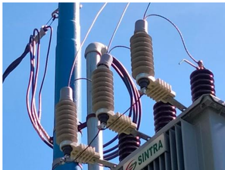
Gambar 3. 5 Ligthning Arrester ( Sumber :Dokumentasi.2022)
