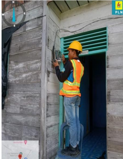
Gambar 2. 25 Memasukkan kode CT ke kwh pelanggan ( Sumber :PLN. Rayon bengkalis PT. Adra gemilang.2022)
