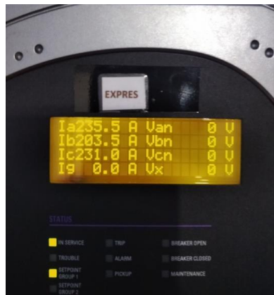
Gambar 2. 15 Memfoto feeder ( Sumber :PLN. Rayon bengkalis PT. Adra gemilang.2022)
