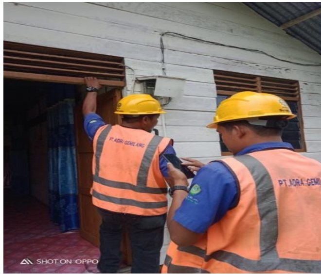
Gambar 2. 59 Memasukkan code CT ( clear temper ) ke kwh meter ( Sumber :PLN. Rayon bengkalis PT. Adra gemilang.2022)
