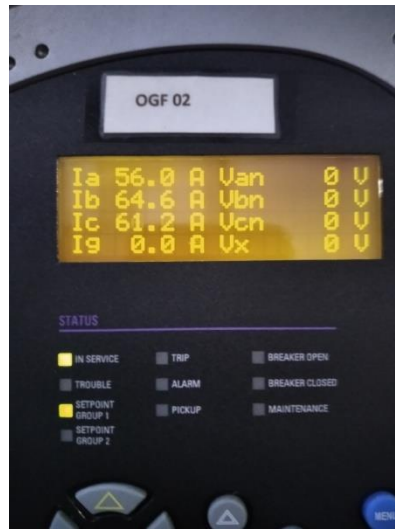
Gambar 2. 50 Evident beban feeder ( Sumber :PLN. Rayon bengkalis PT. Adra gemilang.2022)
