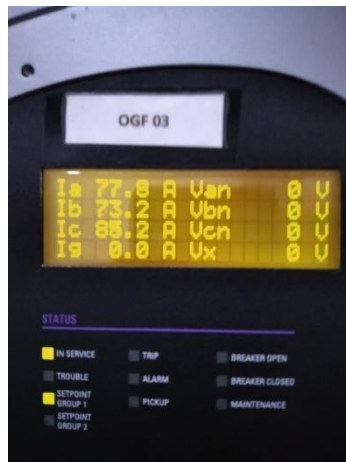
Gambar 2. 32 Evident beban feeder ( Sumber :PLN. Rayon bengkalis PT. Adra gemilang.2022)
