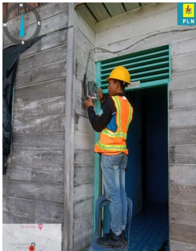
Gambar 2. 55 Memasukkan kode CT ke kwh pelanggan ( Sumber :PLN. Rayon bengkalis PT. Adra gemilang.2022)
