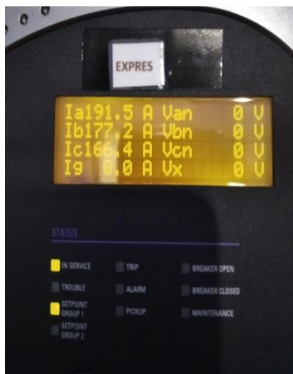
Gambar 2. 19 Evident beban feeder ( Sumber :PLN. Rayon bengkalis PT. Adra gemilang.2022)
