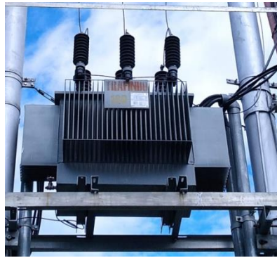
Gambar 3. 2 Transformator Distribusi ( Sumber :PLN. Rayon bengkalis PT. Adra gemilang.2022)
