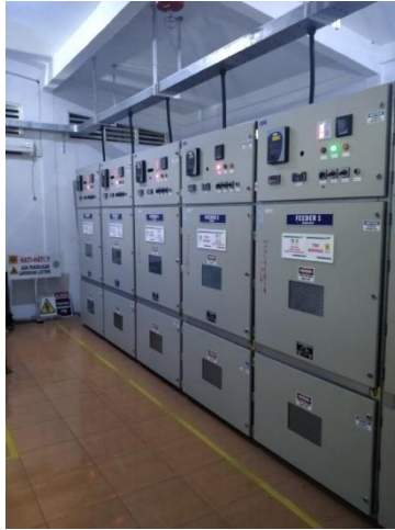
Gambar 2. 46 Evident beban feeder ( Sumber :PLN. Rayon bengkalis PT. Adra gemilang.2022)
