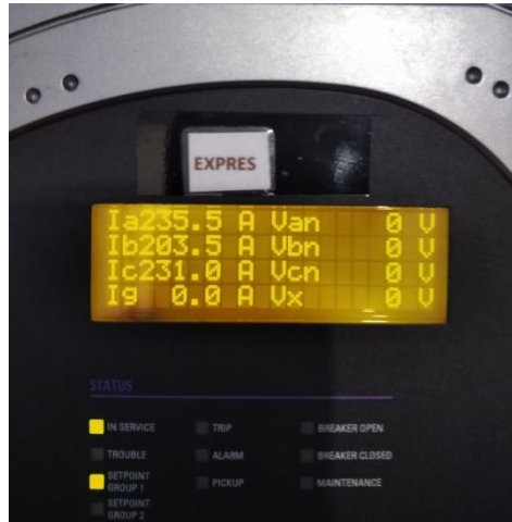
Gambar 2. 16 Memfoto feeder ( Sumber :PLN. Rayon bengkalis PT. Adra gemilang.2022)
