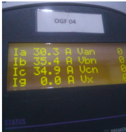
Gambar 2. 53 Evident beban feeder ( Sumber :PLN. Rayon bengkalis PT. Adra gemilang.2022)
