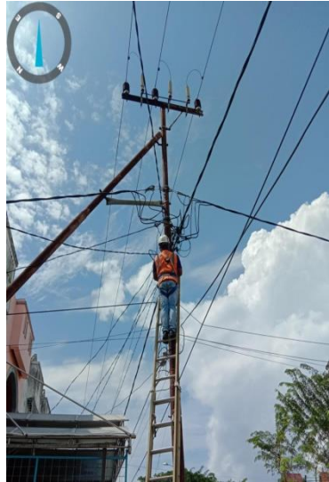
Gambar 2. 33 Memperbaiki kabel SR yang terbakar ( Sumber :PLN. Rayon bengkalis PT. Adra gemilang.2022)
