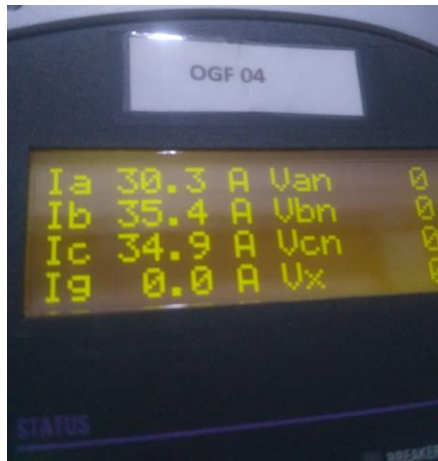
Gambar 2. 23 Evident beban feeder ( Sumber :PLN. Rayon bengkalis PT. Adra gemilang.2022)
