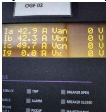
Gambar 2. 54 Evident beban feeder ( Sumber :PLN. Rayon bengkalis PT. Adra gemilang.2022)
