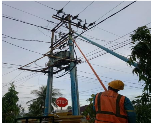
Gambar 2. 71 mengatasi FCO yang putus ( Sumber :PLN. Rayon bengkalis PT. Adra gemilang.2022)
