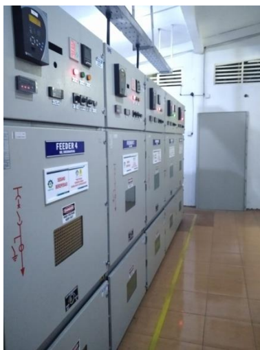
Gambar 2. 56 Evident beban feeder ( Sumber :PLN. Rayon bengkalis PT. Adra gemilang.2022)
