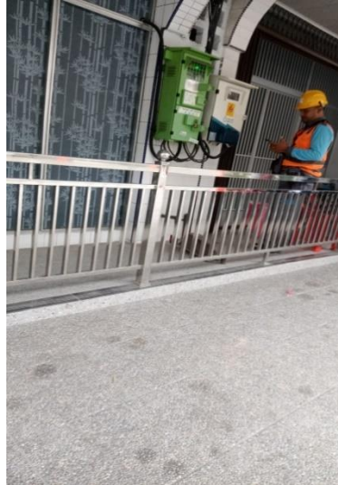
Gambar 2. 45 mengukur tegangan di kwh meter tiga fasa ( Sumber :PLN. Rayon bengkalis PT. Adra gemilang.2022)
