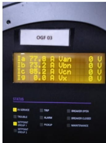
Gambar 2. 68 Evident beban feeder ( Sumber :PLN. Rayon bengkalis PT. Adra gemilang.2022)
