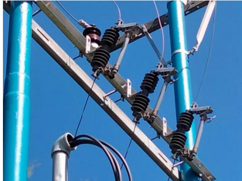
Gambar 3. 3Fuse cut out ( Sumber :Dokumentasi 2022)
