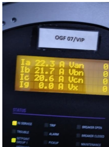
Gambar 2. 49 Evident beban feeder ( Sumber :PLN. Rayon bengkalis PT. Adra gemilang.2022)
