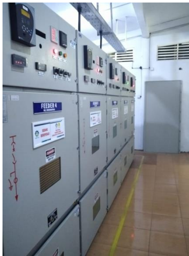
Gambar 2. 37 Evident beban feeder ( Sumber :PLN. Rayon bengkalis PT. Adra gemilang.2022)
