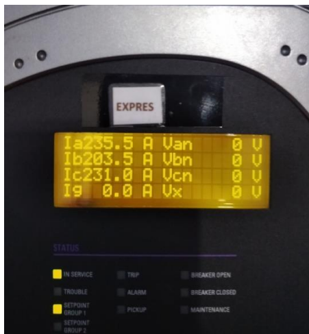
Gambar 2 .63 Memfoto feeder ( Sumber :PLN. Rayon bengkalis PT. Adra gemilang.2022)
