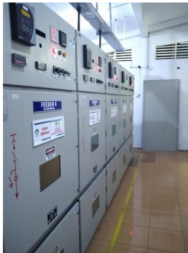
Gambar 2. 26 Evident beban feeder ( Sumber :PLN. Rayon bengkalis PT. Adra gemilang.2022)
