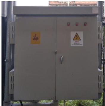
Gambar 3. 11 Perangkat hubung bagi tegangan rendah (PHBTR) ( Sumber :PLN. Rayon bengkalis PT. Adra gemilang.2022)
