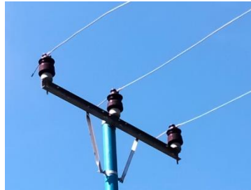
Gambar 3. 9 Post isolator ( Sumber :Dokumentasi.2022)
