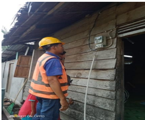
Gambar 2. 72 Pengecekan kwh meter satu rumah padam ( Sumber :PLN. Rayon bengkalis PT. Adra gemilang.2022)
