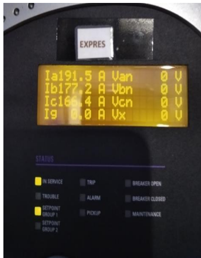
Gambar 2. 73 Evident beban feeder ( Sumber :PLN. Rayon bengkalis PT. Adra gemilang.2022)
