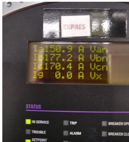
Gambar 2. 42 Evident beban feeder ( Sumber :PLN. Rayon bengkalis PT. Adra gemilang.2022)
