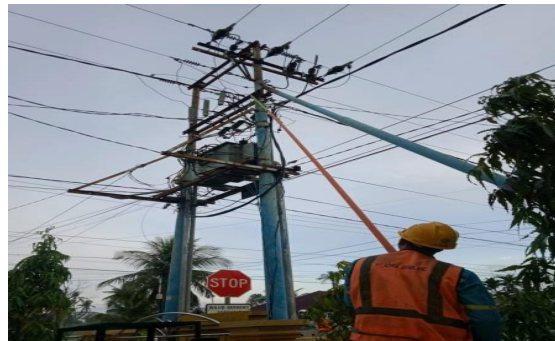
Gambar 2. 17 mengatasi FCO yang putus ( Sumber :PLN. Rayon bengkalis PT. Adra gemilang.2022)
