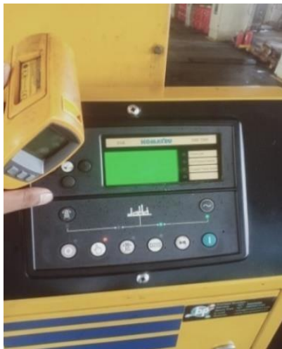
Gambar 2.42 Kegiatan monitoring KWH setiap jamnya (Sumber: PT. Megapower Makmur Tbk, 2022)
