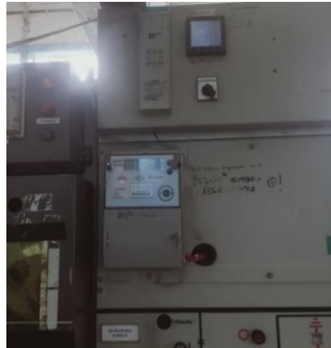
Gambar 2.38 Kegiatan monitoring KWH setiap jamnya (Sumber: PT. Megapower Makmur Tbk, 2022)
