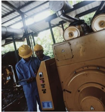
Gambar 2.3 Kegiatan monitoring KWH setiap jamnya (Sumber: PT. Megapower Makmur Tbk, 2022)
