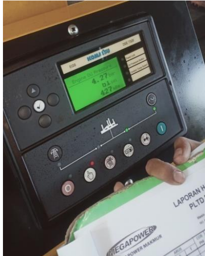
Gambar 2.11 Kegiatan monitoring KWH setiap jamnya (Sumber: PT. Megapower Makmur Tbk, 2022)
