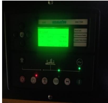
Gambar 2.43 Kegiatan monitoring KWH setiap jamnya (Sumber: PT. Megapower Makmur Tbk, 2022)
