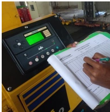
Gambar 2.10 Kegiatan monitoring KWH setiap jamnya (Sumber: PT. Megapower Makmur Tbk, 2022)
