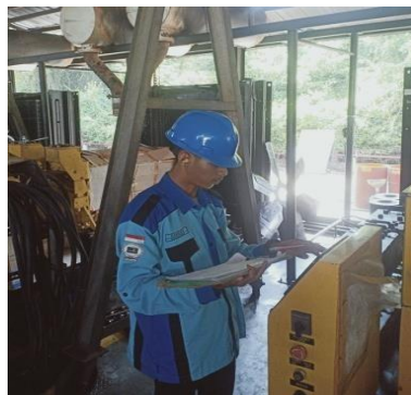
Gambar 2.4 Kegiatan monitoring KWH setiap jamnya (Sumber: PT. Megapower Makmur Tbk, 2022)
