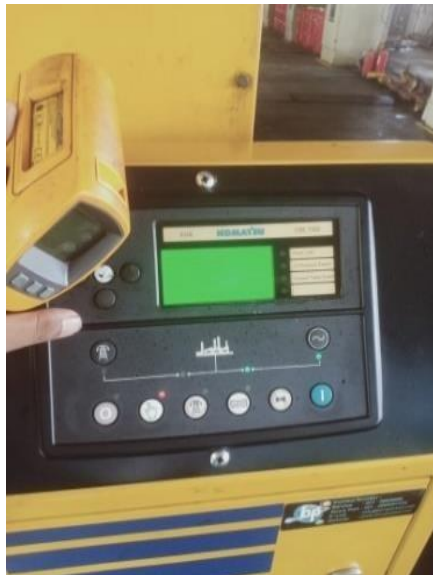
Gambar 2.37 Kegiatan monitoring KWH setiap jamnya (Sumber: PT. Megapower Makmur Tbk, 2022)
