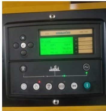
Gambar 2.19 Kegiatan monitoring KWH setiap jamnya (Sumber: PT. Megapower Makmur Tbk, 2022)
