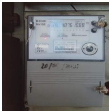
Gambar 2.40 Kegiatan monitoring KWH setiap jamnya (Sumber: PT. Megapower Makmur Tbk, 2022)
