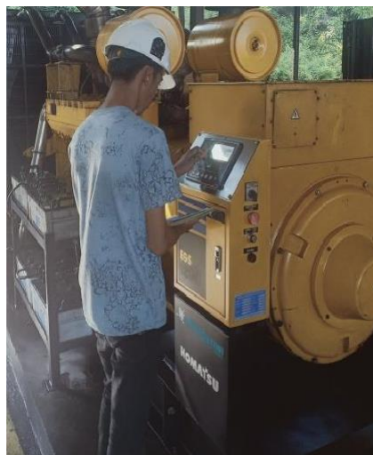
Gambar 2.17 Kegiatan monitoring KWH setiap jamnya (Sumber: PT. Megapower Makmur Tbk, 2022)
