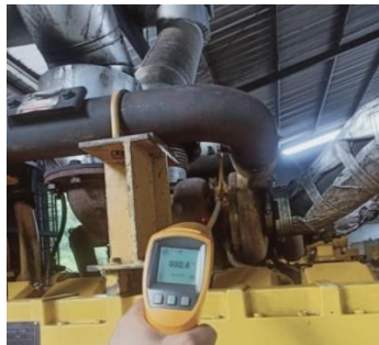
Gambar 2.44 Kegiatan monitoring KWH setiap jamnya (Sumber: PT. Megapower Makmur Tbk, 2022)
