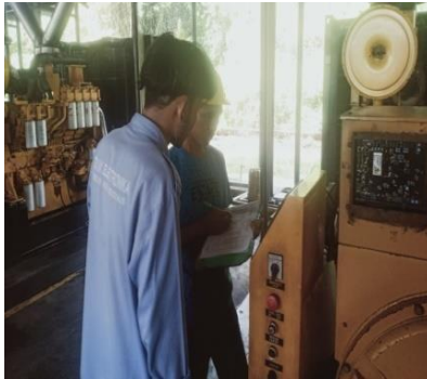
Gambar 2.13 Kegiatan monitoring KWH setiap jamnya (Sumber: PT. Megapower Makmur Tbk, 2022)
