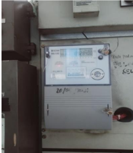
Gambar 2.36 Kegiatan monitoring KWH setiap jamnya (Sumber: PT. Megapower Makmur Tbk, 2022)
