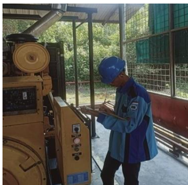
Gambar 2.5 Kegiatan monitoring KWH setiap jamnya (Sumber: PT. Megapower Makmur Tbk, 2022)
