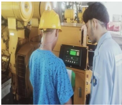
Gambar 2.14 Kegiatan monitoring KWH setiap jamnya (Sumber: PT. Megapower Makmur Tbk, 2022)
