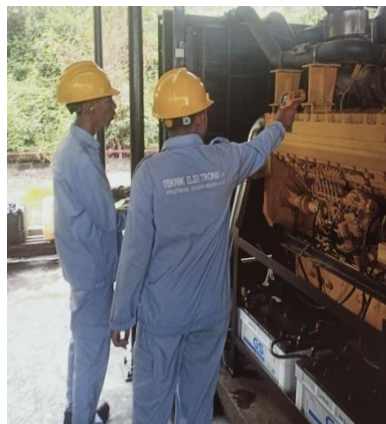
Gambar 2.15 Kegiatan monitoring KWH setiap jamnya (Sumber: PT. Megapower Makmur Tbk, 2022)
