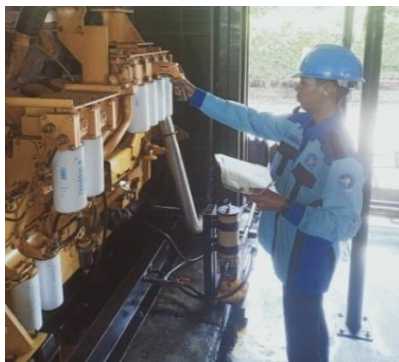
Gambar 2.9 Kegiatan monitoring KWH setiap jamnya (Sumber: PT. Megapower Makmur Tbk, 2022)
