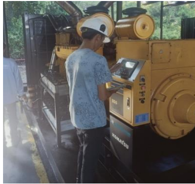
Gambar 2.8 Kegiatan monitoring KWH setiap jamnya (Sumber: PT. Megapower Makmur Tbk, 2022)
