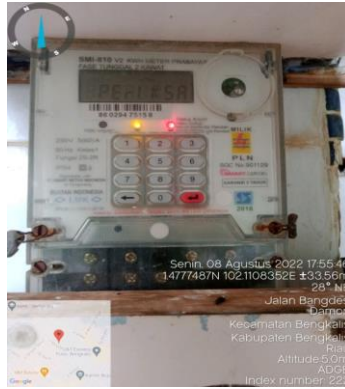
Gambar 2.46 Mengatasi kwh periksa (Sumber: PT. Adra Gemilang 2022)
