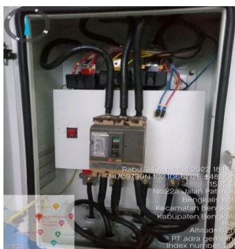
Gambar 2.57 Pemadaman bergilir (Sumber: PT. Adra Gemilang 2022)
