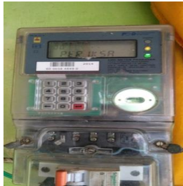
Gambar 2.60 Mengatasi kwh periksa di rumah pelanggan (Sumber: PT. Adra Gemilang 2022)
