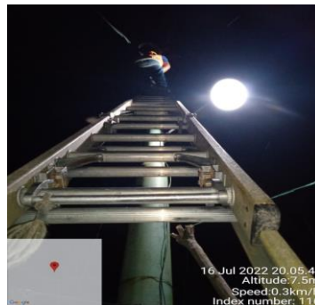
Gambar 2.32 Mengatasi gangguan los kontak (Sumber: PT. Adra Gemilang 2022)
