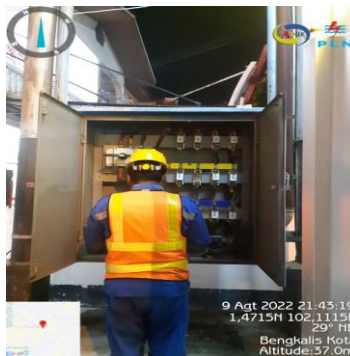
Gambar 2.47 Pemadaman bergilir (Sumber: PT. Adra Gemilang 2022)
