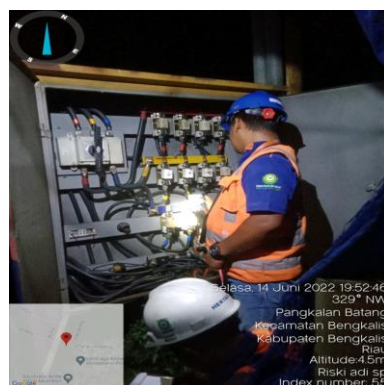
Gambar 2.10 Penyeimbangan beban trafo
