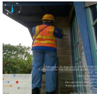
Gambar 2.56 Mengatasi kwh periksa di rumah pelanggan. (Sumber: PT. Adra Gemilang 2022)
