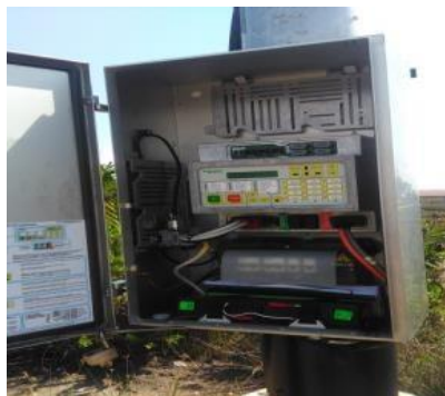
Gambar 2.30 Mengatasi RC ( Recloser ) Trip (Sumber: PT. Adra Gemilang 2022)
