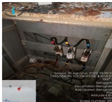
Gambar 2.51 Menggaanti NH fuse (Sumber: PT. Adra Gemilang 2022)
