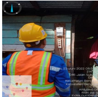
Gambar 2.36 Mengatasi gangguan los kontak ( Sumber: PT. Adra Gemilang 2022 )
