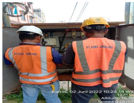
Gambar 2.2 Penyimbangan beban trafo (Sumber: PT. Adra Gemilang)
