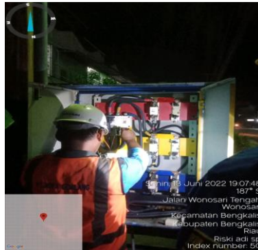
Gambar 2.9 Penyeimbangan beban trafo
