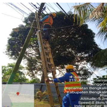
Gambar 2.25 Mengatasi gangguan los kontak (Sumber: PT. Adra Gemilang 2022)
