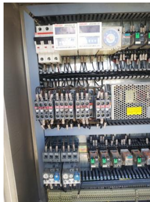
Gambar 2. 30 panel box mesin pengangkut limbah padat
